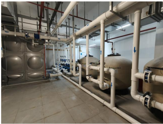
游泳池循环水过滤系统 (玻璃纤维石英砂过滤器)
