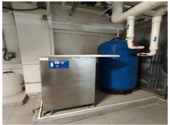
游泳池臭氧发生器
