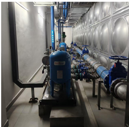
地下泵房中的水泵及减震基座
