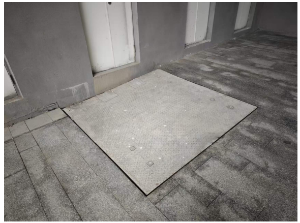
综合废水排放口（DW001）
