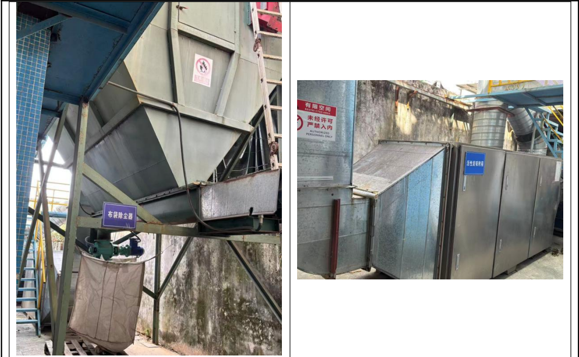
图 2-5 废气治理设施照片
