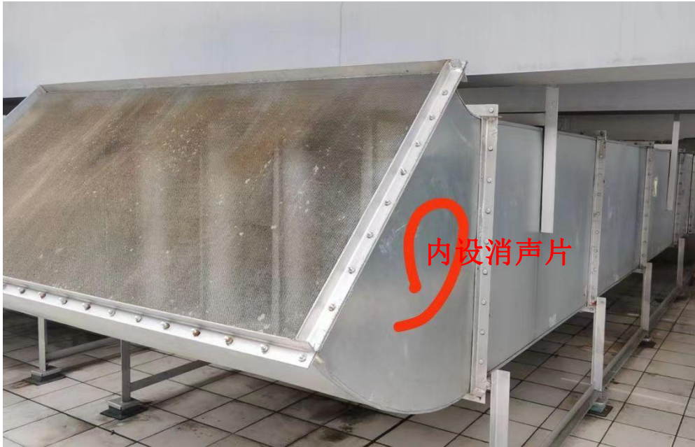
图 5.7-2 项目油烟排放口情况
