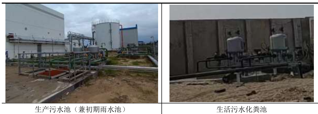
图 4.1-3 废水处理设施现场照片
