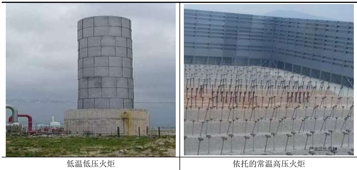
图 4.1-1 项目第一阶段工程废气处理设施照片
