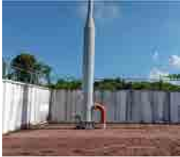
站场放空立管
