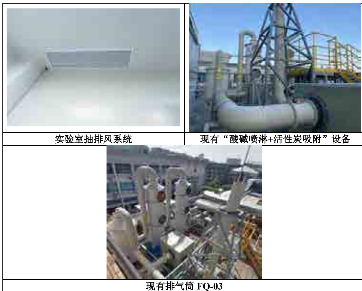
图4.1-4 项目废气处理设施图
