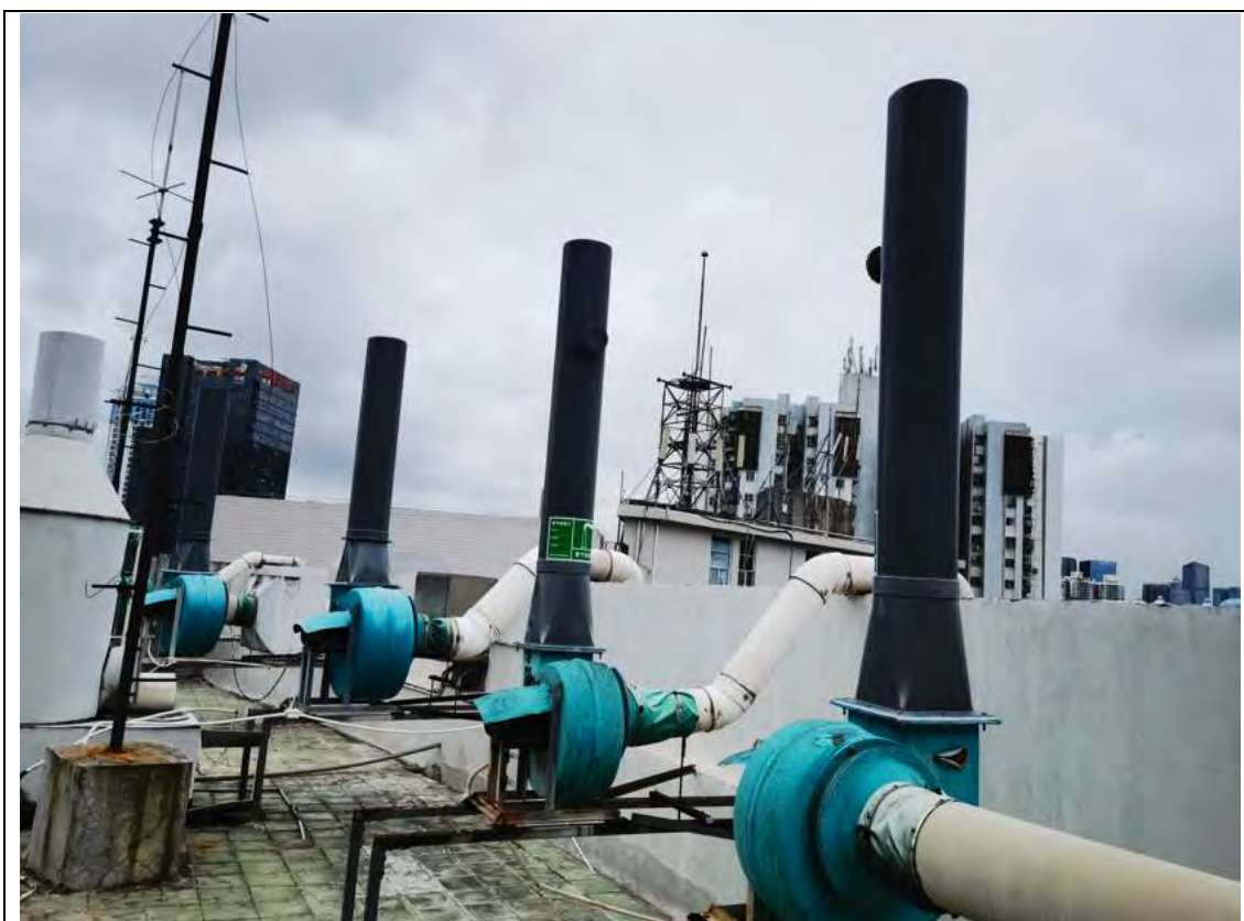
图 3-2 楼顶部分废气排气筒
