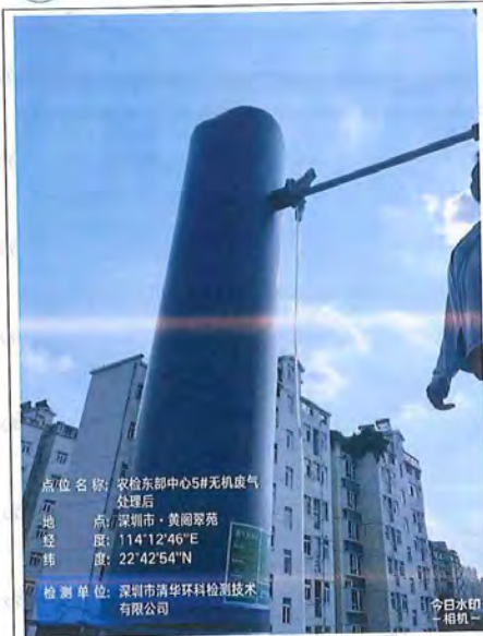
无机废气处理后检测口
