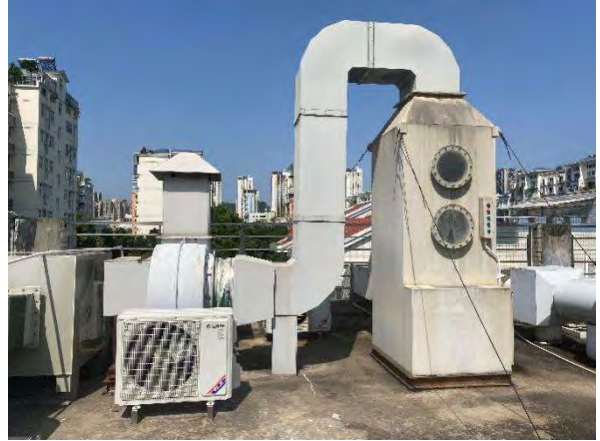
喷淋塔处理系统
