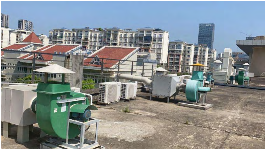
图 3-2 部分废气处理系统
