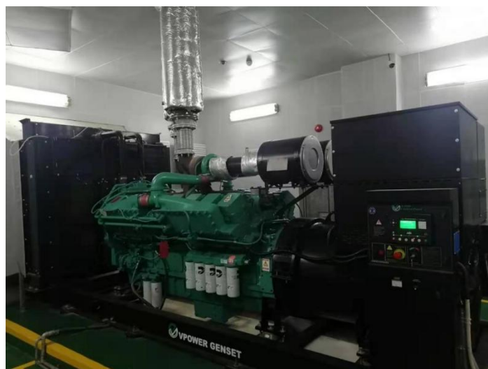
备用发电机设置底座，位于地下层机房
