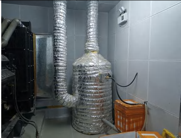
备用发电机燃油尾气治理设施
