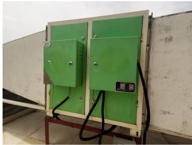
厨房油烟治理设施
