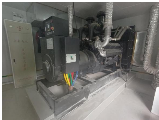
备用发电机设置底座，位于机房内
