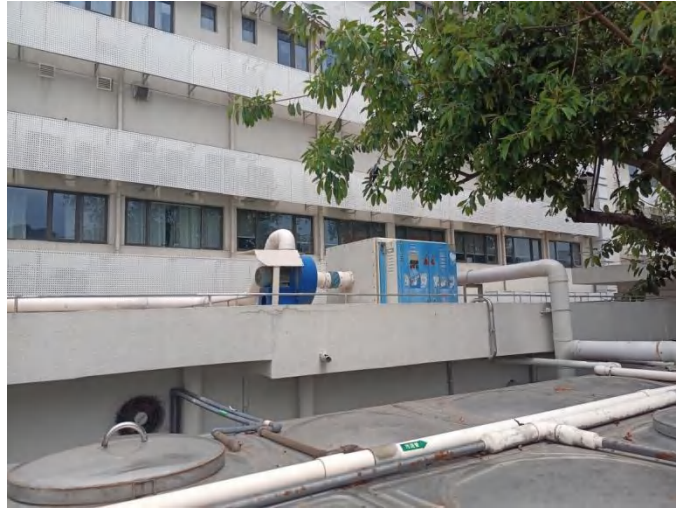
污水处理站臭气治理设施
