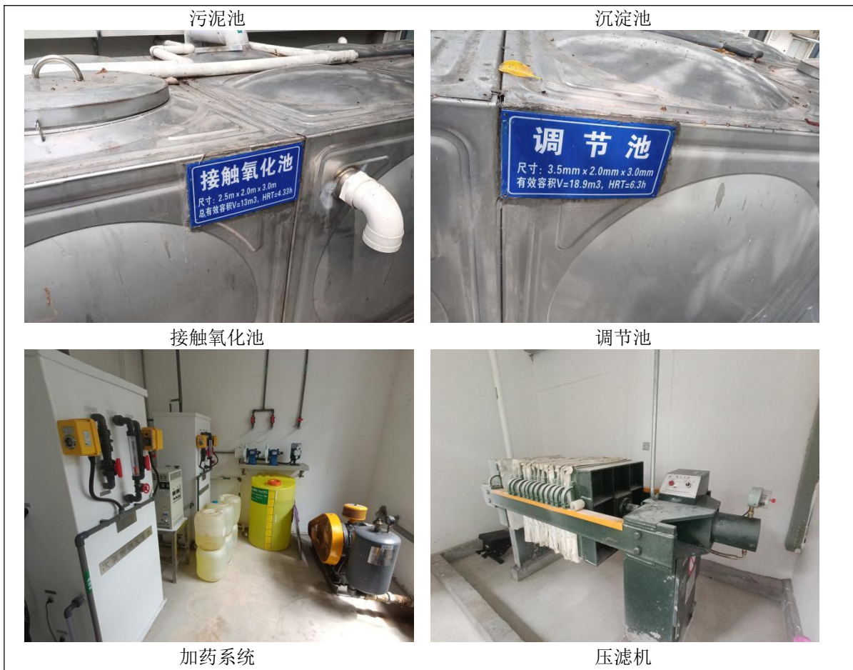
图 3-2 废水治理设施图片
