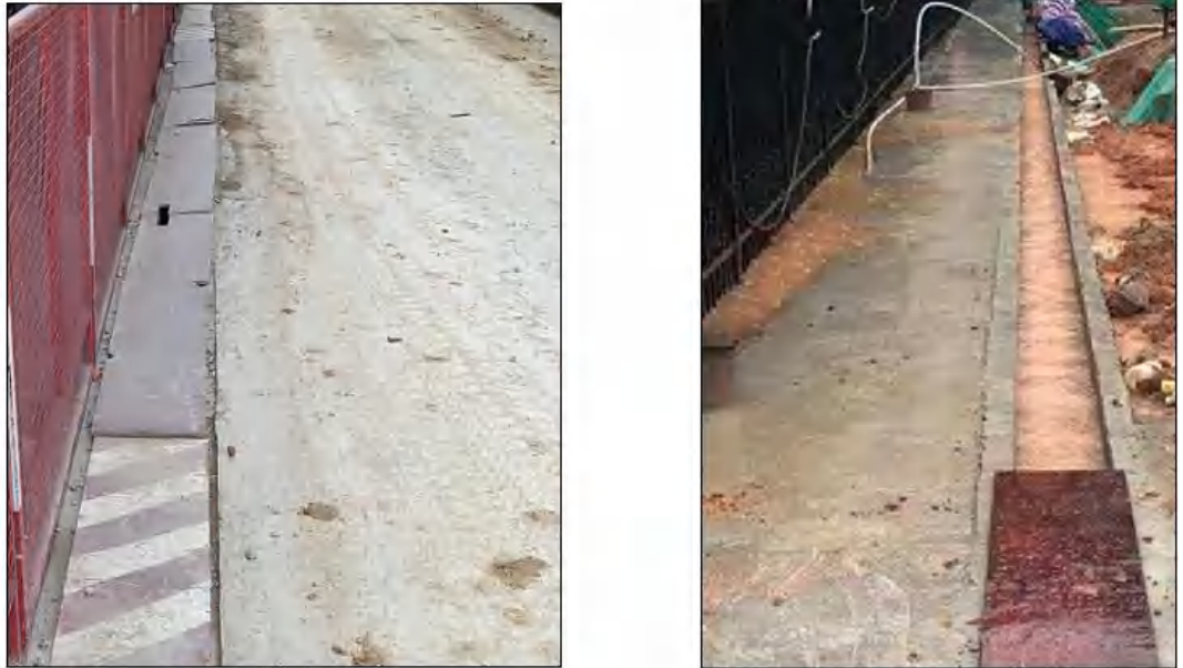
废水收集及排水沟
