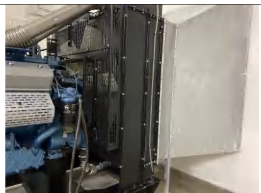
电机尾气净化装置
