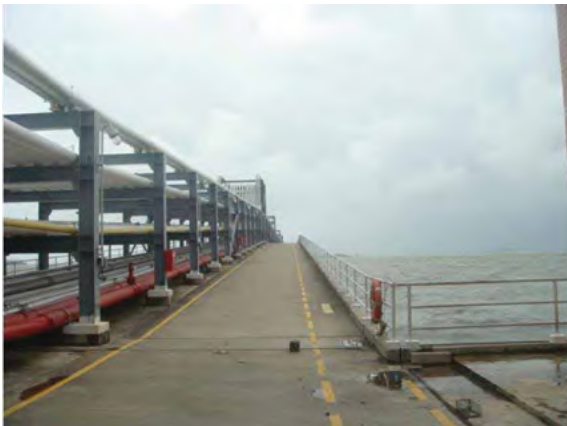
图 3.2-1 码头现有工程（输送管道）
