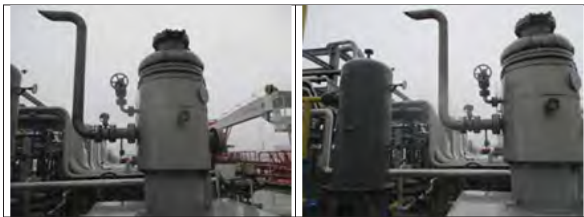
图 3.5-2 码头现有工程活性炭吸附塔设置情况
