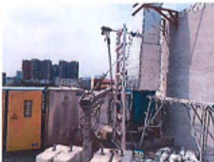
有组织废气总排放口
