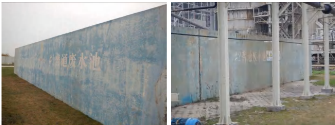
图 3.6-8 综合污水处理站普通废水池
