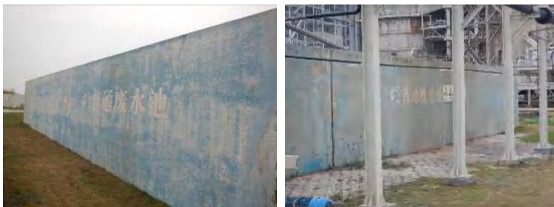
图 3.6-8 综合污水处理站普通废水池
