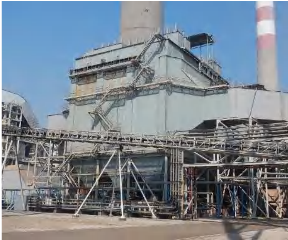
图 3.6-12 电袋复合除尘器
