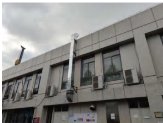
现有废水处理站废气排放口
