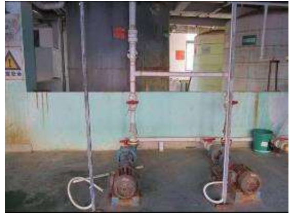
罐区围堰及管道控制阀
