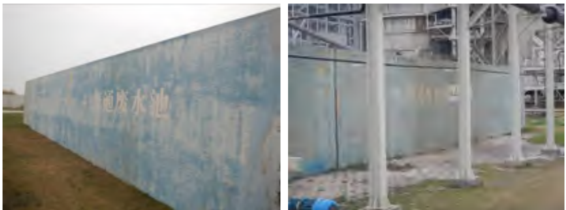
图 3.6-8 综合污水处理站普通废水池
