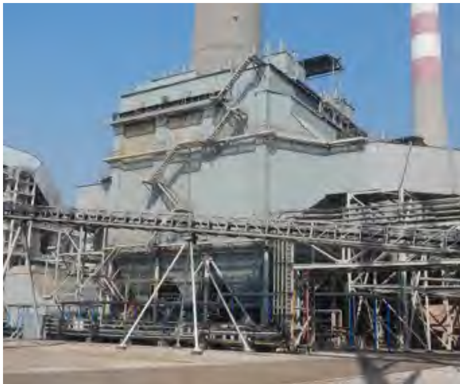
图 3.6-12 电袋复合除尘器
