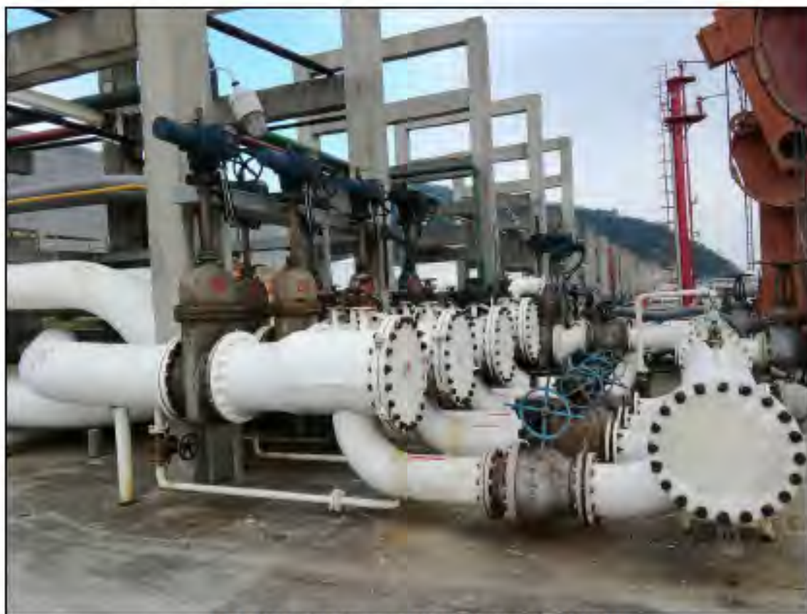
图 3.2-7 码头现有工程管线布置现状照片
