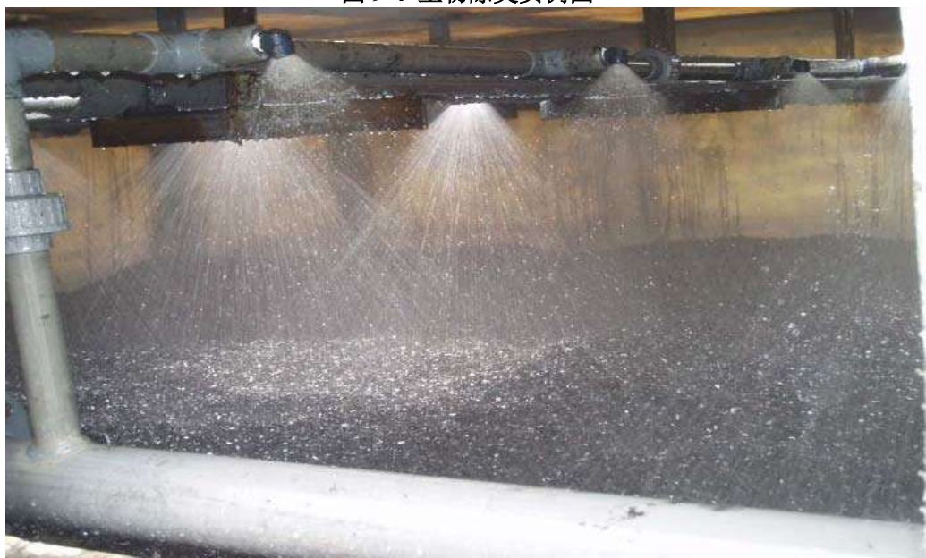
图 9-5 除臭塔散水状态图
