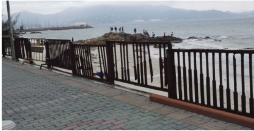
图 1-2 杨梅坑堤顶护栏锈蚀
