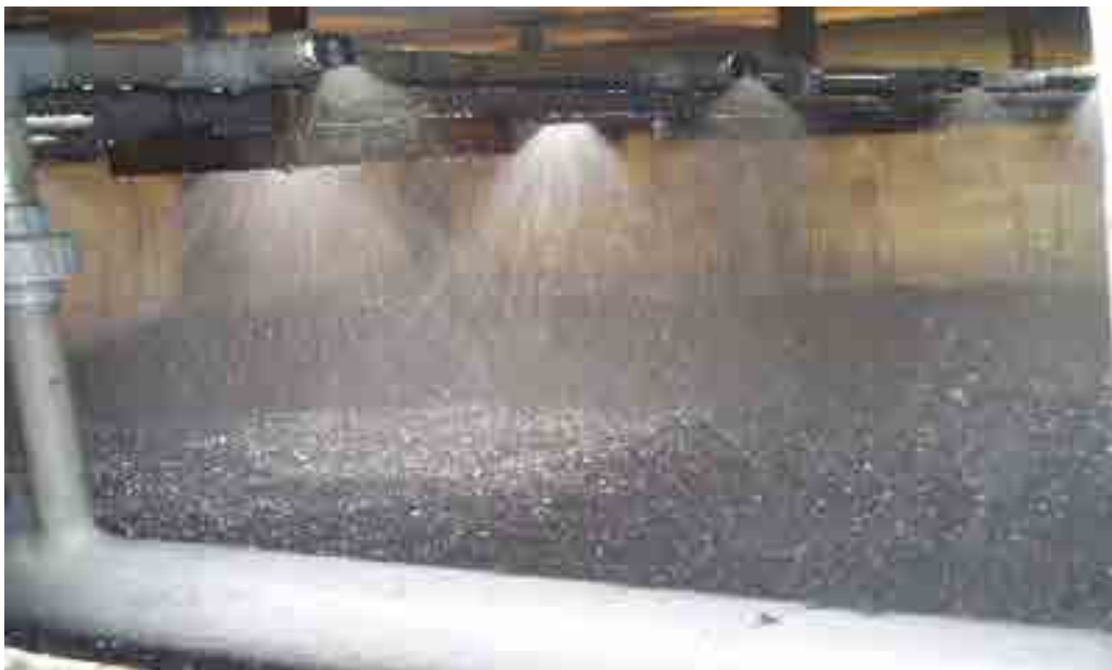
图 9.2-5 除臭塔散水状态图
